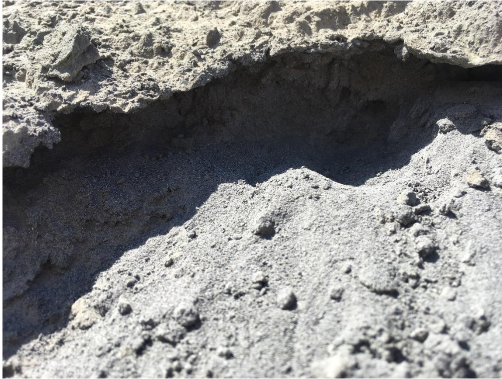
Ilustración 7: Tranque Tamaya, costra visible por paso de maquinaria en borde
